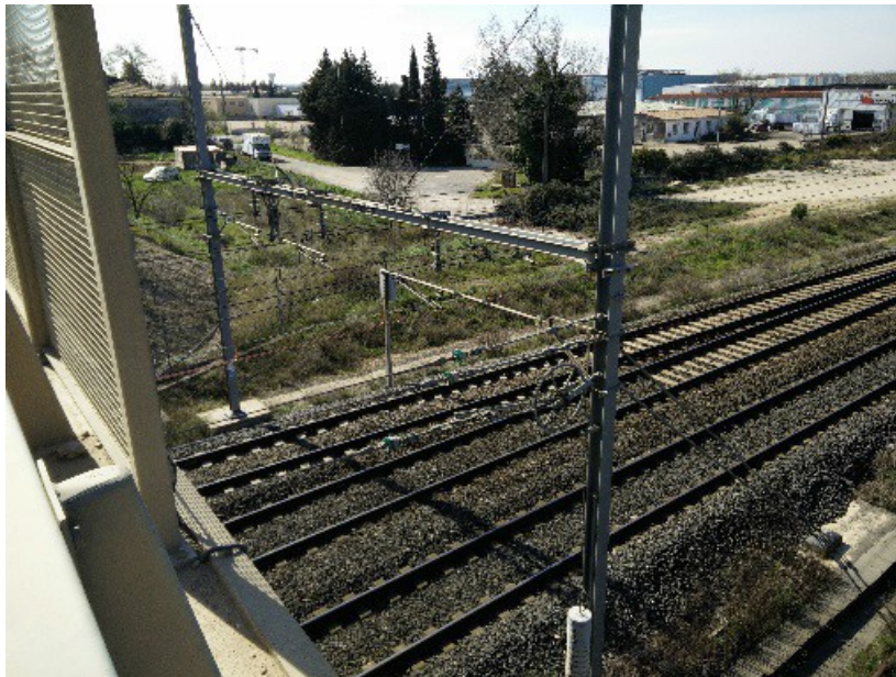
Caténares avec ancrages côté Ouest
